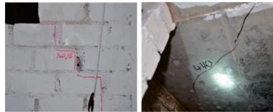
(a) A轴二层纵墙开裂
